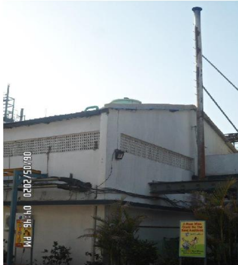
Annexure No- 6 - D.G Set Stack
